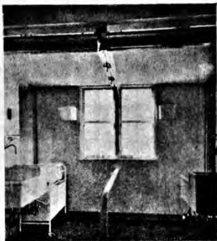
Fig. 4. — Empleo de lámparas germicidas en la desinfección de salas de hospitales. La lámpara está colocada en la línea media del techo.
