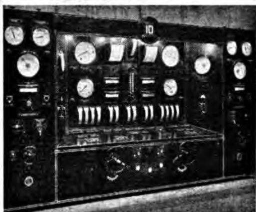
Fig. 9.—Sobre cada una de las calderas está fijado un panel de control que da una información completa de la presión del vapor, de las temperaturas y otros datos. Las instrucciones del cuarto central de mando se pasan a cada operario que controla las condiciones requeridas de vapor, que varían según el circuito de utilización de la central.
