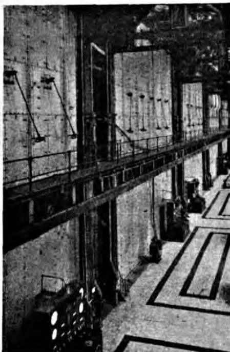
Fig. 12.—Esta vista del pasillo elevado de control que corre en el total de los 146 metros del pabellón de calderas de la central "A", permite apreciar las líneas precisas con que se proyectó la central.
