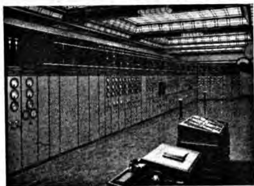
Fig. 10.—La instalación completa de la central se controla desde este cuarto y todo el manejo de interruptores se inicia aquí, las presiones en todos los circuitos aparecen indicadas en los diversos instrumentos.
